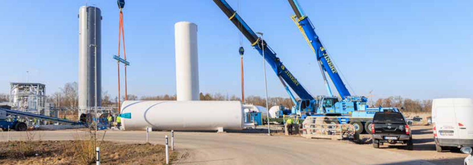
Drivkraften för Tekniska verken är att ta vara på koldioxid i stället för att släppa ut den och på så vis tränga ut fossil koldioxid. Foto: Tekniska verken, Joakim Sjöholm.
