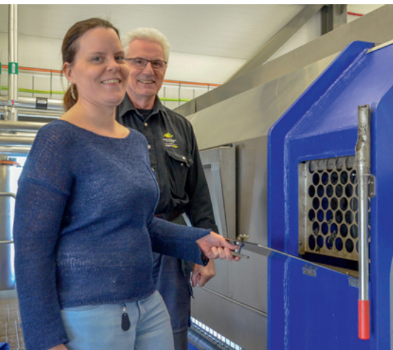
Lina Norling, projektledare och Ulf Nilsson, automationsingenjör undersöker slammet via inspektionsluckan på slamppressen.
