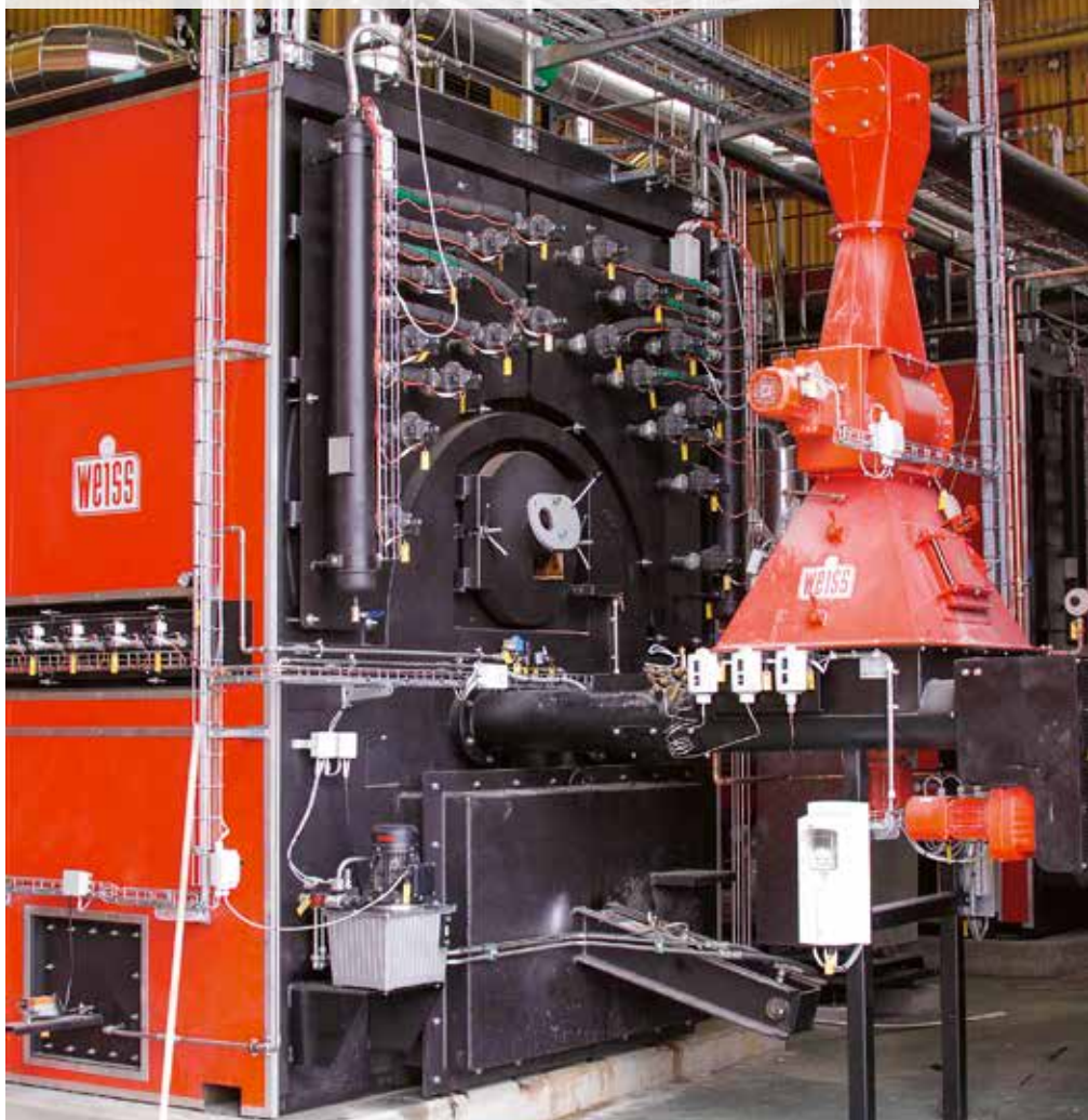
Arboga Energi installerade pelletspannor 2012 och 2013. Drifterfarenheterna har hittills varit goda.
